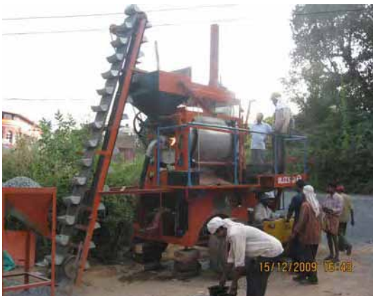
Plate 1 Mini hot mix plant
